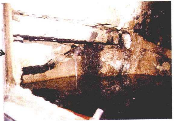
Detalle de la captación del agua
